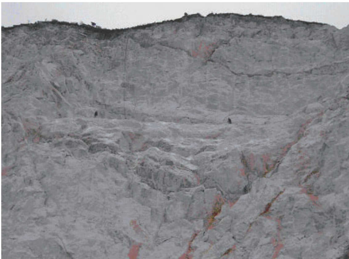
圖 7.2_1 梨樹溝項目 糟糕的坑壁狀況
